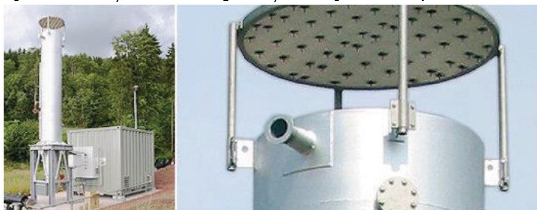
Figura 10-29: Stația de ventilare a gazelor și flacăra gazelor la temperaturi înalte
